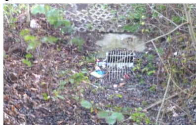
Bild 5: Gänsaugraben, durch das Gitter fließt bei Bedarf Quellwasser in den Kanal.
